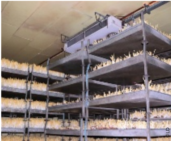
Les deux salles de forçage doivent être chauffées à 10 °C.
