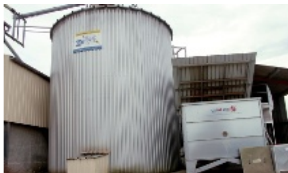
L'association d'une chaudière à plaquettes avec une cellule sécheuse.
